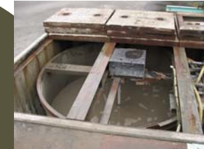
切断水貯泥水タンク
