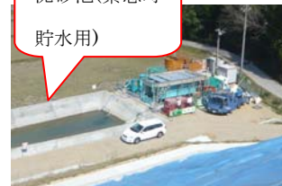
装置の設置状況
