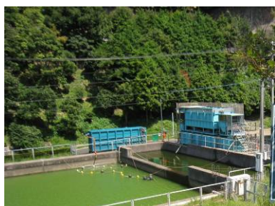
装置の設置状況
