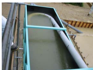
凝集促進槽の状況
