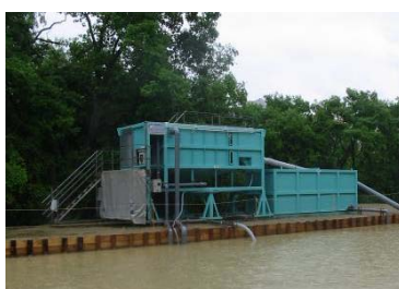
装置の設置状況
